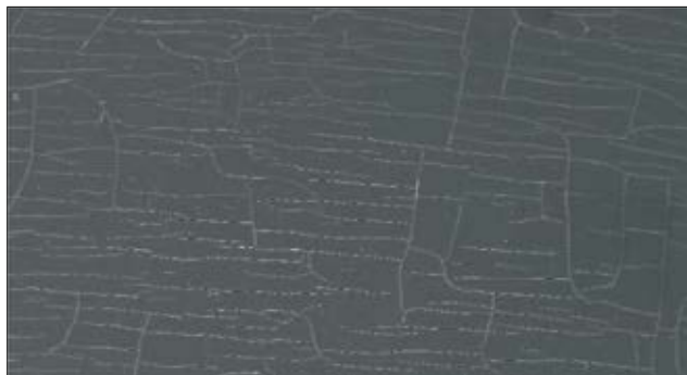
Muestra dañada por todas partes por la radiación UV.
